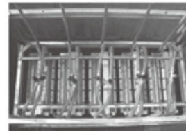
膜分離活性汚泥法
