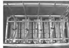
膜分離活性汚泥法
